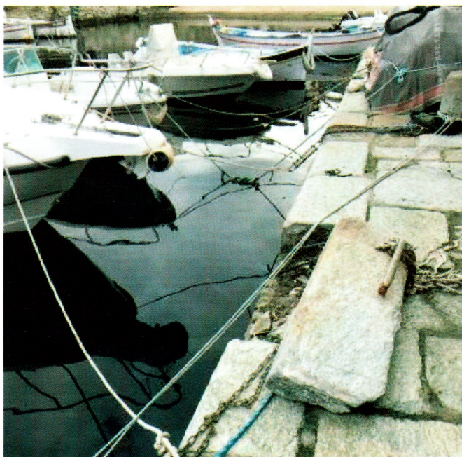
Pierre de parement déchaussée
