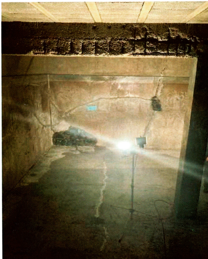
Dégradations de l'intérieur du réservoir de Palombese
