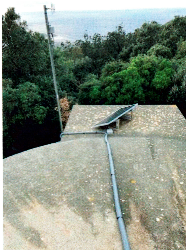
Système de pilotage automatique, fonctionnant à l'énergie solaire, réservoir de Trelo
